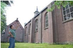
Jan de Vries kent de gebouwen en het restauratieplan op zijn duimpje. Hij wijst talloze scheuren in muren, verdrukte en losgewrikte stenen en verrot houtwerk aan, die de aanpak van de fundering en de restauratie noodzakelijk maken. (Foto: Marius van Deursen)
