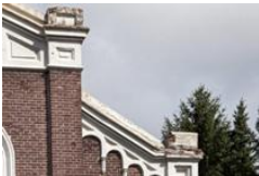
Op deze foto is de deplorabele toestand van muren, stucwerk en daklijsten goed zichtbaar. (Foto: Marius van Deursen)
